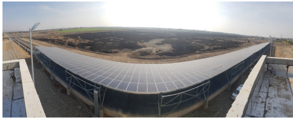
شکل ۳- نصب پنل‌ها روی کانال فاضلاب و امتداد در مسیر آن در نیروگاه ۴۰۰ کیلوواتی تصفیه‌خانه جنوب تهران (راه‌اندازی نیروگاه خورشیدی در تصفیه‌خانه فاضلاب جنوب تهران، ۱۳۹۷)
