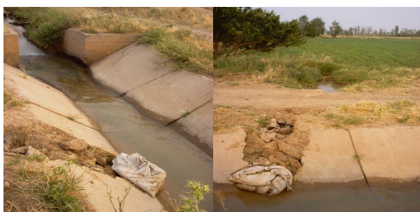
شکل ۳- شکستن کانال انتقال آب جهت بهره‌برداري (I.1)
