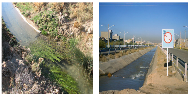
شکل ۴- عدم لایروبی کانال‌های انتقال آب به دلیل دولتی بودن و عدم مشارکت بهره‌برداران در نگهداری (I.2)
