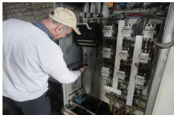
شکل ۳- اندازه‌گیری مقادیر مرتبط با مصارف انرژی در تابلو برق ایستگاه پمپاژ
