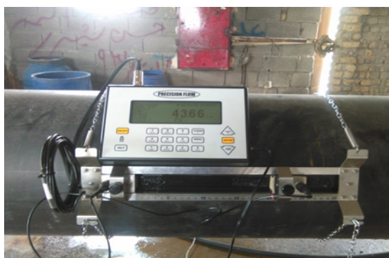
شکل ۲- پایش دبی لحظه‌ای در محل ایستگاه پمپاژ با استفاده از دبی سنج اولتراسونیک
