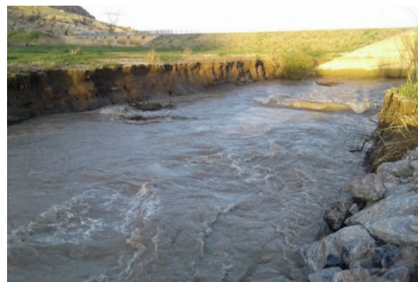
شکل ۶- فرسایش کناری در بستر رودخانه
