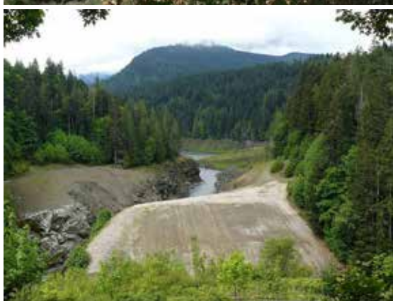
شکل ۴- سد برقابی الوها به ارتفاع ۳۲ متر، در ابتدای تخریب (بالا) وضعیت دره یکسال بعد از تخریب (پائین)
