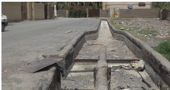
شکل ۳- خشک شدن قنات پرآب قنبرآباد شیخی شهرستان بم به علت انسداد یکی از میله‌چاه‌ها در اثر عملیات عمرانی- اردیبهشت ۱۴۰۱
