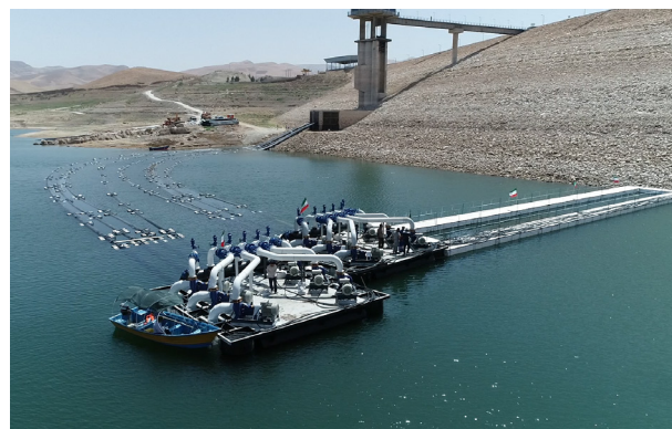
شکل ۸- ایستگاه پمپاژ شناور در حال بهره‌برداری، مرداد ۱۴۰۲
